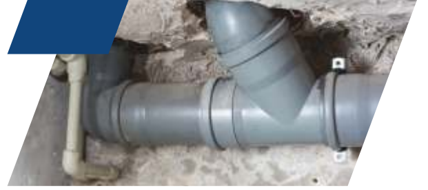
Atık Su Tesisatı
