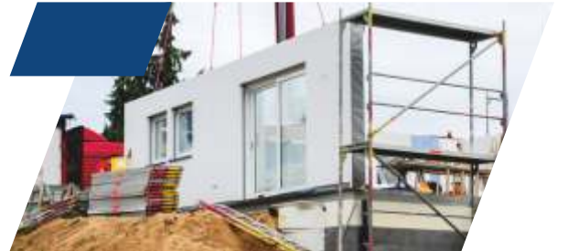
Prefabrik Yapı ve Konteyner Tesisatı
