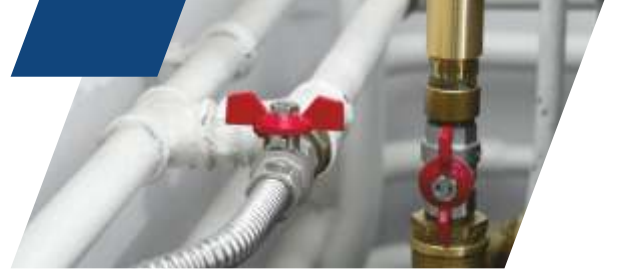
Sıcak Su Tesisatı
