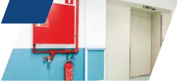
Yangın Dolabı Tesisatları
